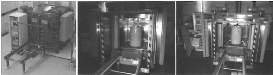
図2 設置型クリアランス計測設備
